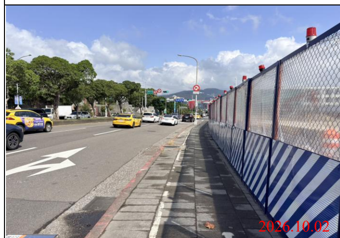
巡查日期地點：115.10.02/ Y34車站 照片說明：路面狀況
